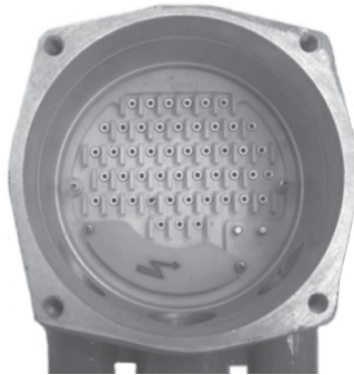
Internal earth stud
