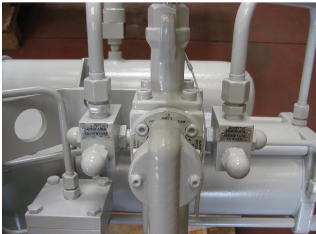
Figure 27. Vannes de régulation du débit
